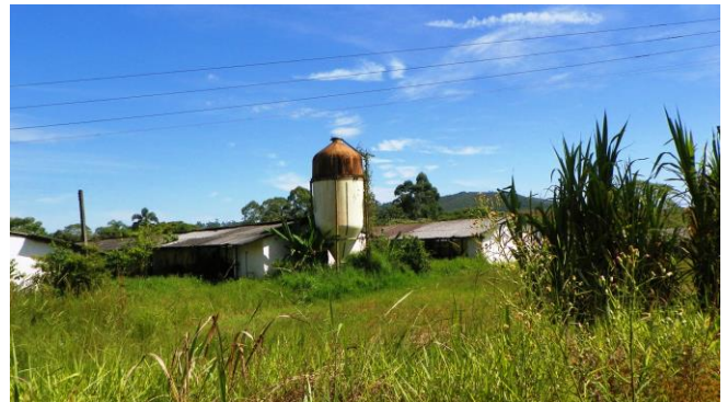
16. Item 67 - Silo de fibra de vidro
